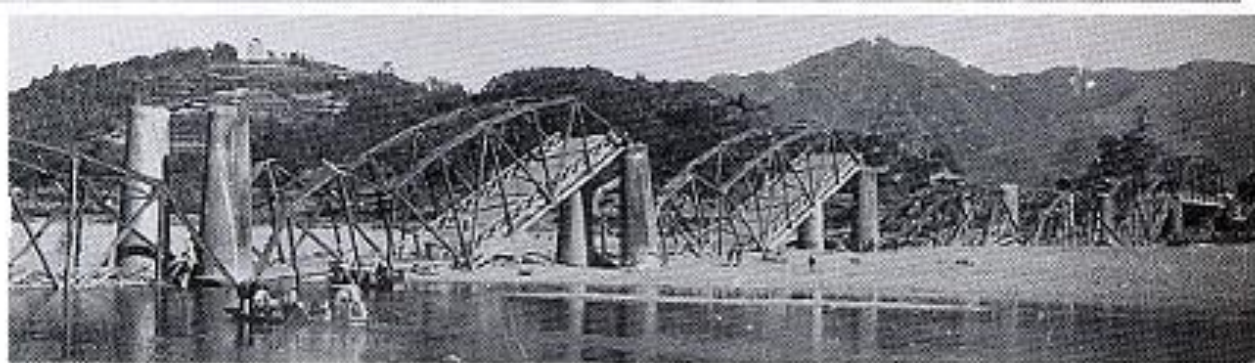
中村市の鉄橋では橋げたが8カ所壊れた
